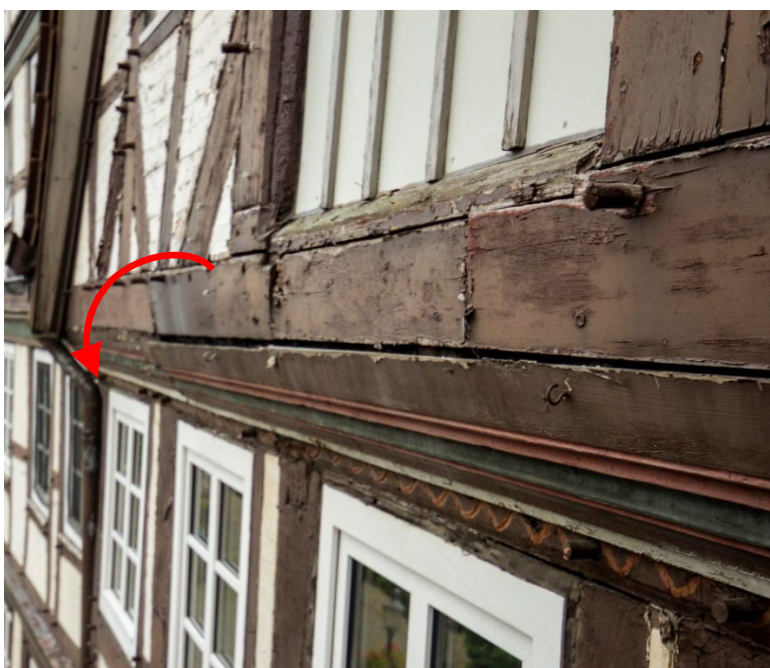
Bild 10: An der Schwelle des Giebfachwerks zeigt sich die Gefahr durch die zurückgeschnittenen Deckenbalkenköpfe: Die Schwelle dreht unter Belastung nach außen.
