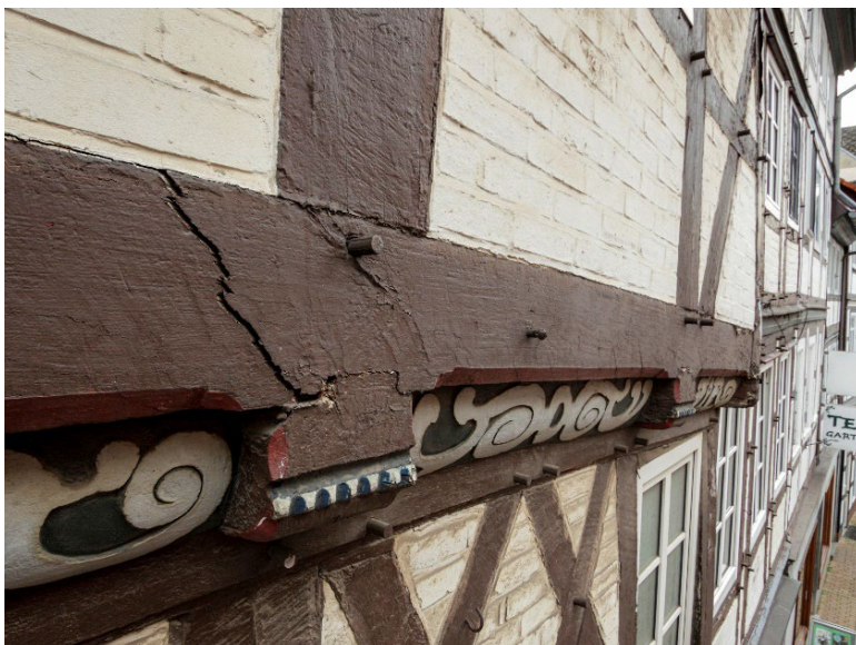
Bild 9: Durch die starken horizontalen Verformungen weisen die Schwellen und Rähme mehrfach Brüche auf. Diese Brüche treten typisch an Schwachstellen wie Drehwuchs oder Astigkeit auf. Teils resultieren die Schwächungen wohl auch durch Pilzbefall von der Ober- und Rückseite aus. Alle neuen Reparaturen werden mit Altholz Eiche ausgeführt.
